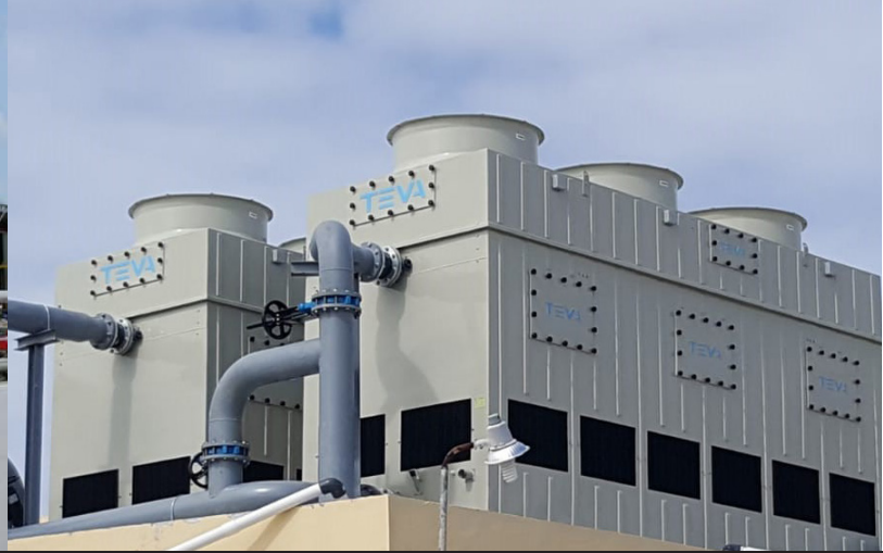
HOTEL BE LIVE (PUNTA CANA) AIR CONDITIONING
